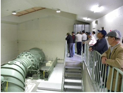
伊太小水力発電所
